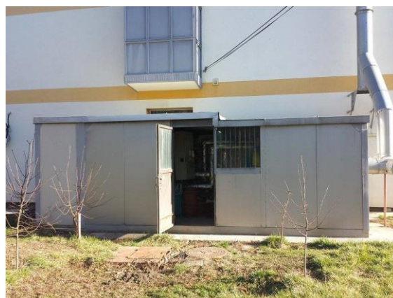
CENTRALĂ TERMICĂ PARC
